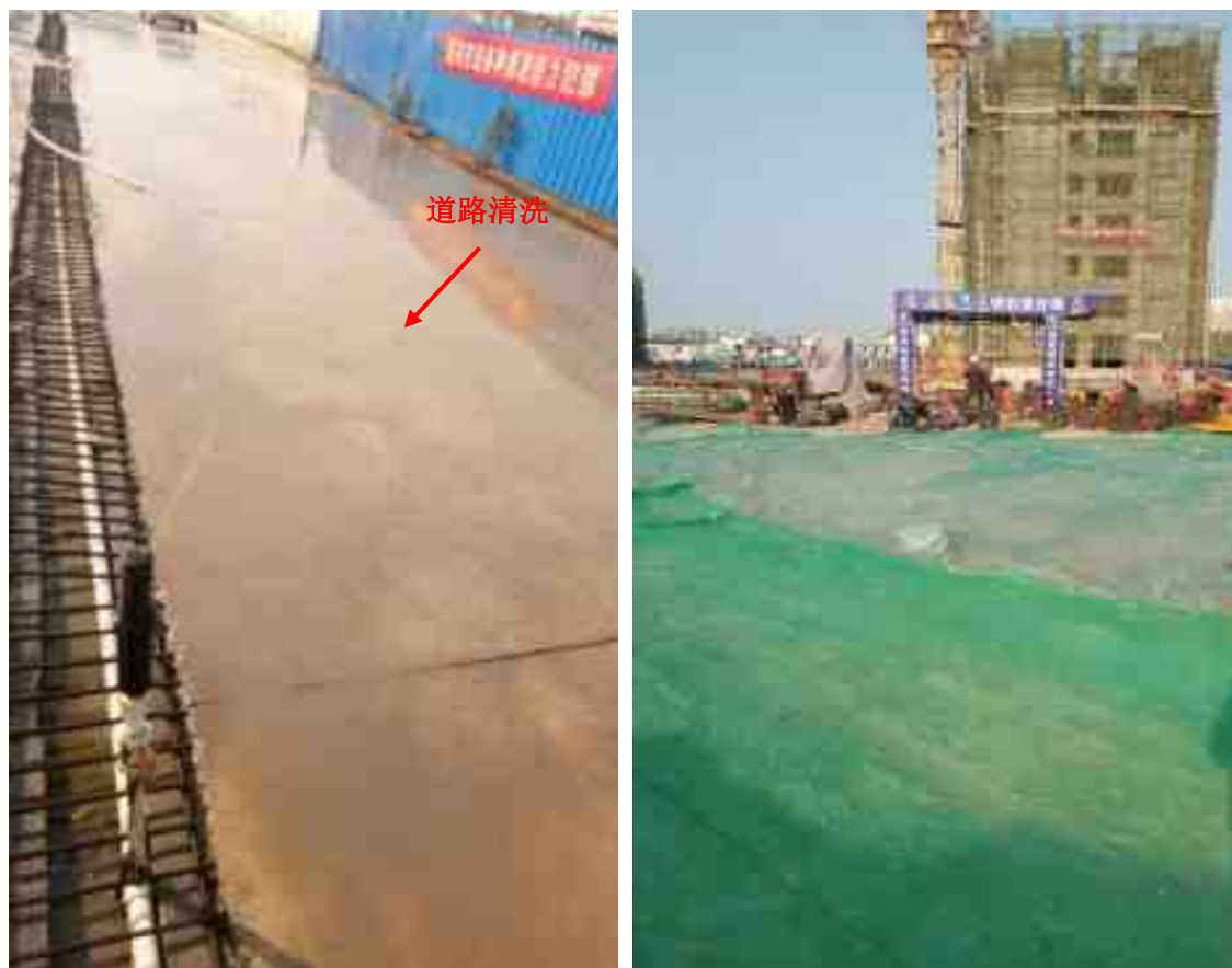
图 4-1 施工期废气治理设施照片
