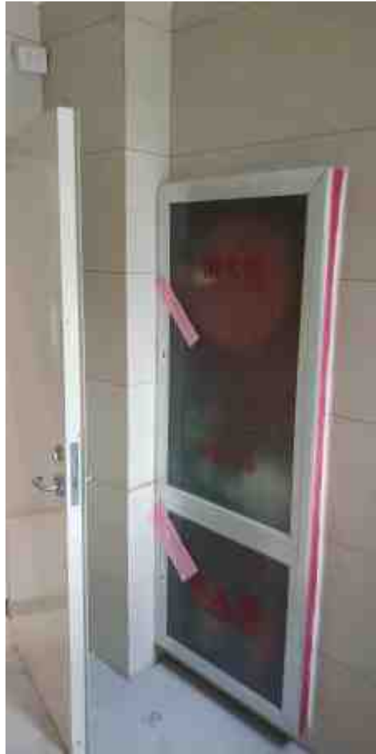
室内消火栓、灭火器、防火门
